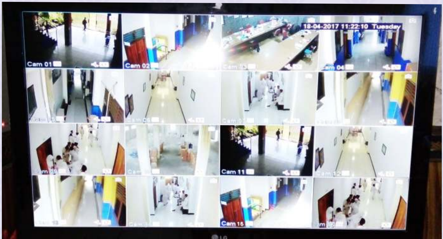
Monitoring CCTV Gedung SMA IT Al-Madinah di Ruang Kepala Sekolah
